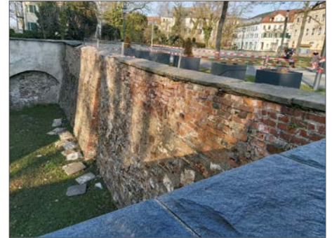
Stützwand am Schlossvorplatz vor der Sanierung.
