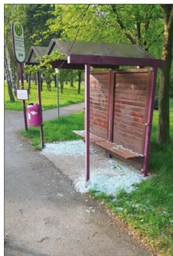
Leider musste am Samstag, den 13.04. an der Bushaltestelle Talstraße wieder Vandalismus festgestellt werden. Neben den zerstörten...
