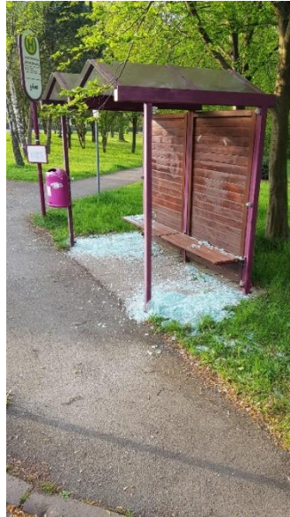
Leider musste bereits am Samstag, den 13.04. an der Bushaltestelle Talstraße wieder Vandalismus festgestellt werden.
